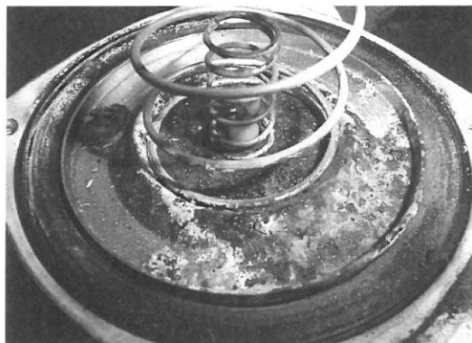
カバー内部の腐食
