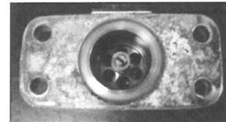
放出防止弁接続面の腐食
