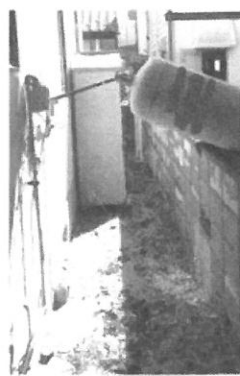
〈洪水被害を受けた供給設備〉
