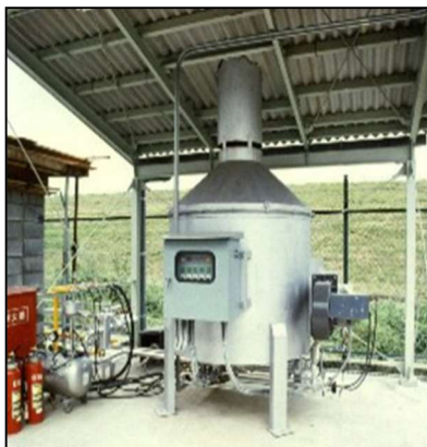
残ガス燃焼装置
