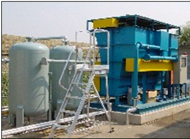
処理水ろ過装置
