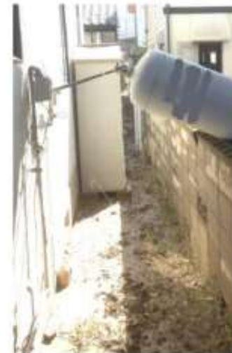
〈洪水被害を受けた供給設備〉
