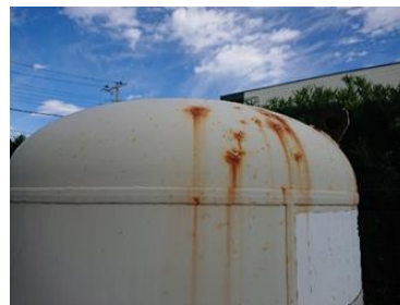
バルク貯槽上部
