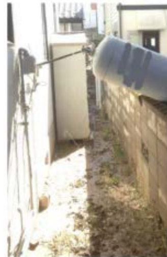
〈洪水被害を受けた供給設備〉
