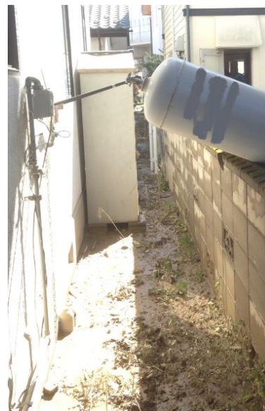
〈洪水被害を受けた供給設備〉
