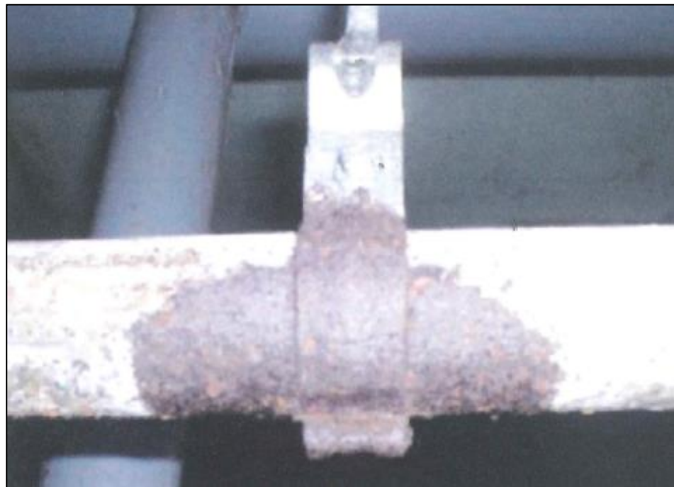
ピット内で異種金属同士が触れ合う箇所の腐食
