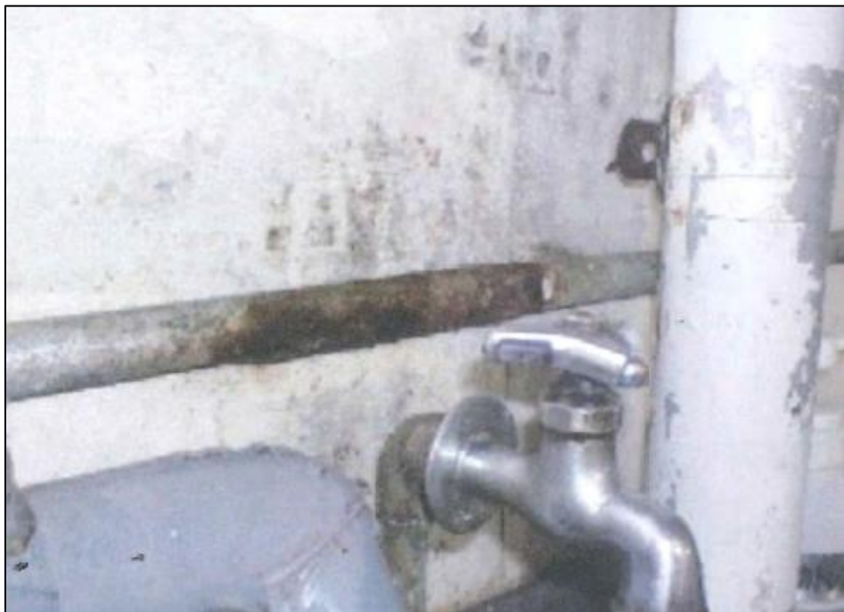
水しぶきのかかる蛇口付近に設置された配管の腐食
